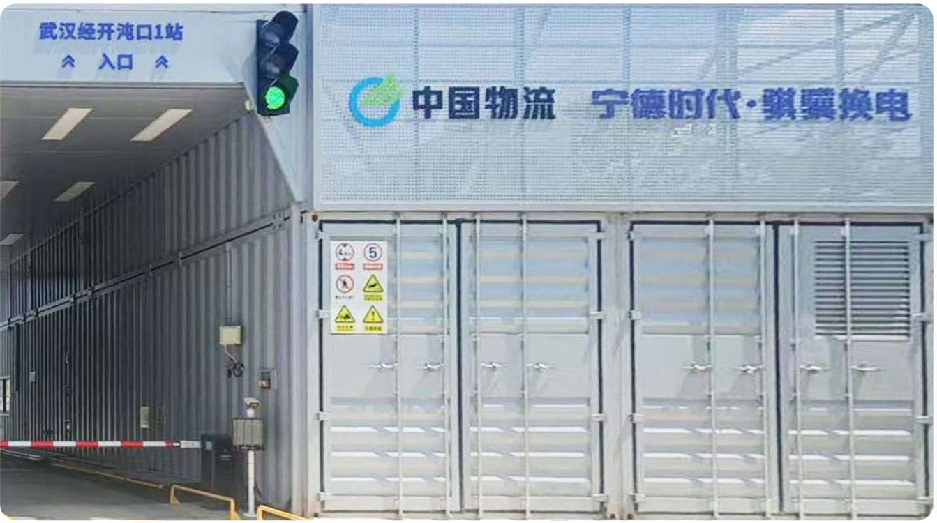
生产基地投建换电站
